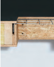
WIEHAG Lichtausschnitt mit fixer Absturzsicherung
