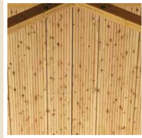
Capannone di produzione per Weißhaidinger Ingenieur Holzbau GmbH: struttura portante Freespan WIEHAG in combinazione con elementi costruttivi per tetti Profidec WIEHAG in legno di pino e superficie fonoisolante
